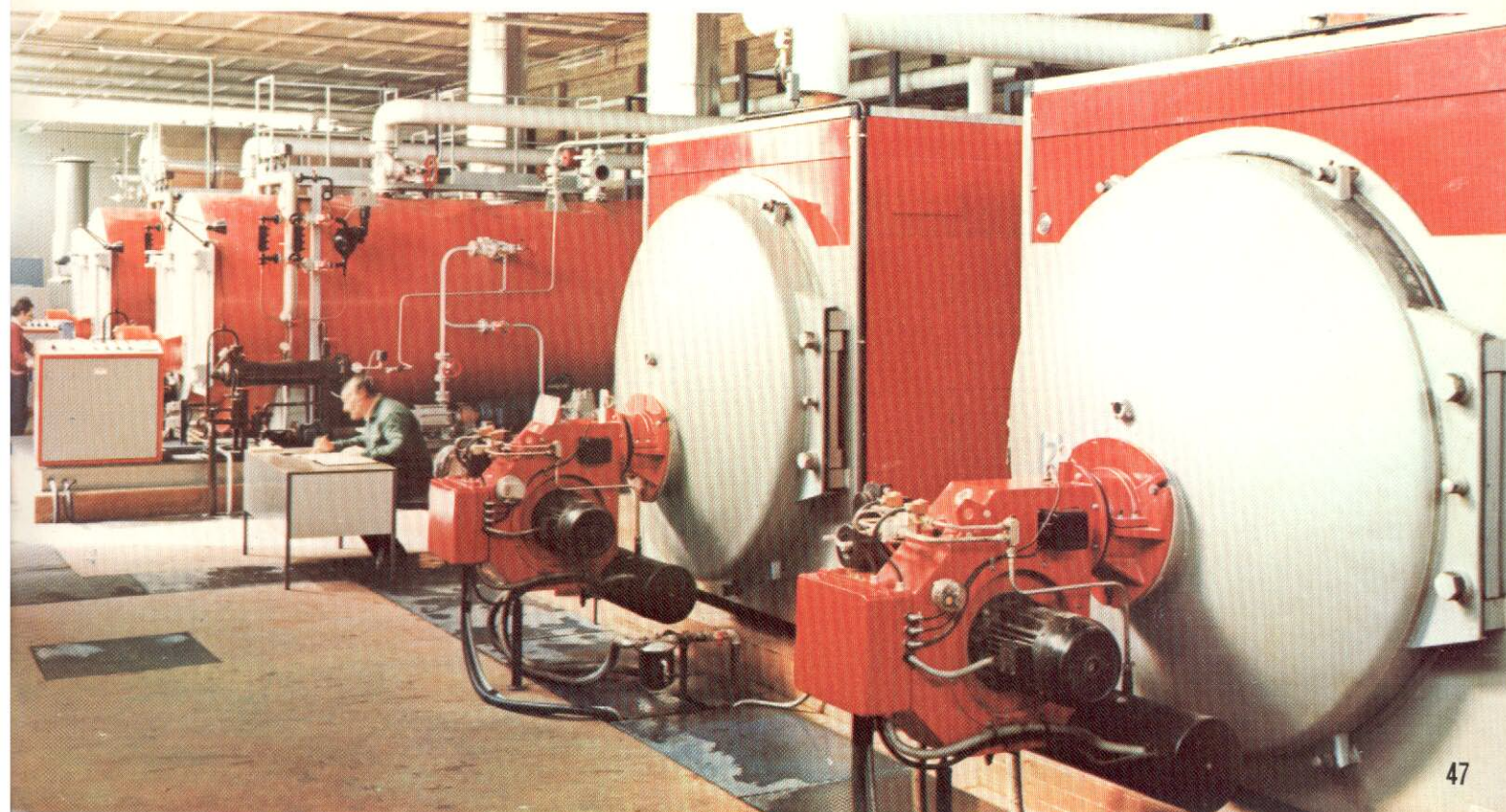
47-48) Centrale termica per produzione di vapore a 12 ATE, potenzialità 6.000.000 cal/h e acqua calda 85/75, potenzialità 5.000.000 cal/h.
