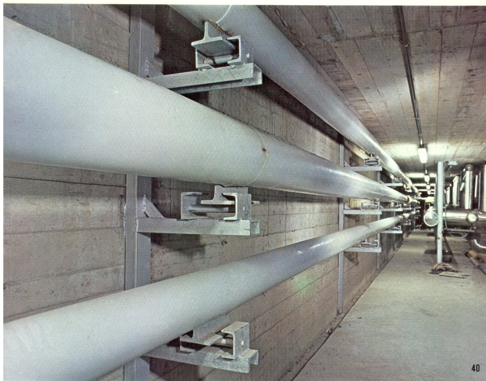
40) Linee di trasporto vapore-condensa-aria. 41-42-43) Particolare ravvicinato di sistemi di guida e scorrimento con rulli di linee ad olio diatermico ad isolamento continuo.
