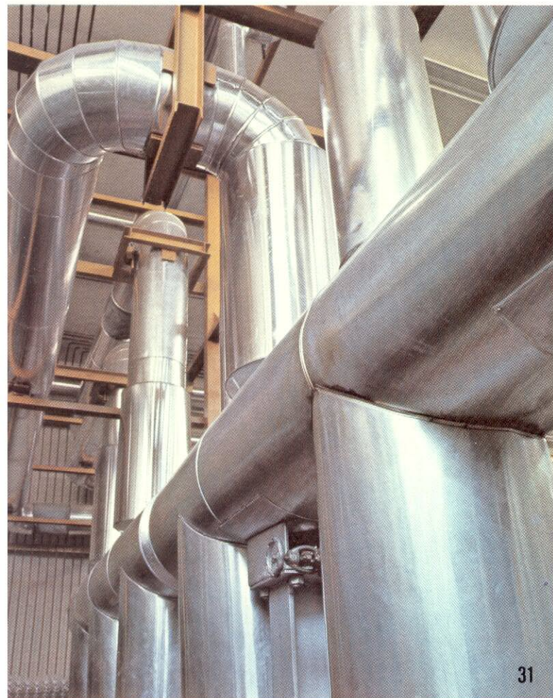
Reti di distribuzione olio diatermico a 300°C. 31-32-33-34) Particolari degli staffaggi, slitte e rulli, giunti snodati e sferici I.W.K.A. coibentati con amianto, rulli e guide per isolamento continuo delle tubazioni.
