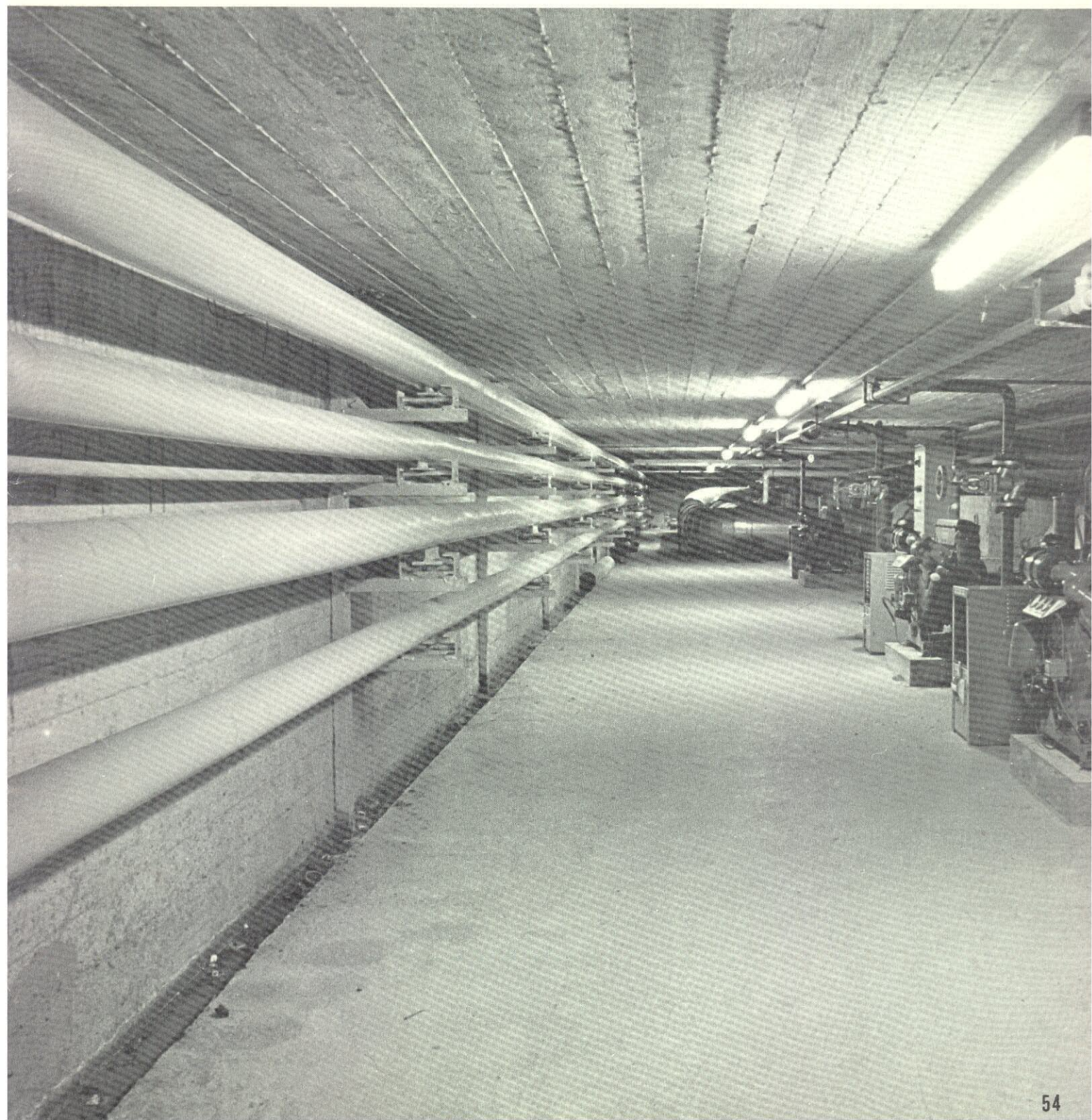
54) Centrali di produzione aria compressa, priva di olio, acqua e con temperatura di rugiada di -20^{\circ}\text{C} .
